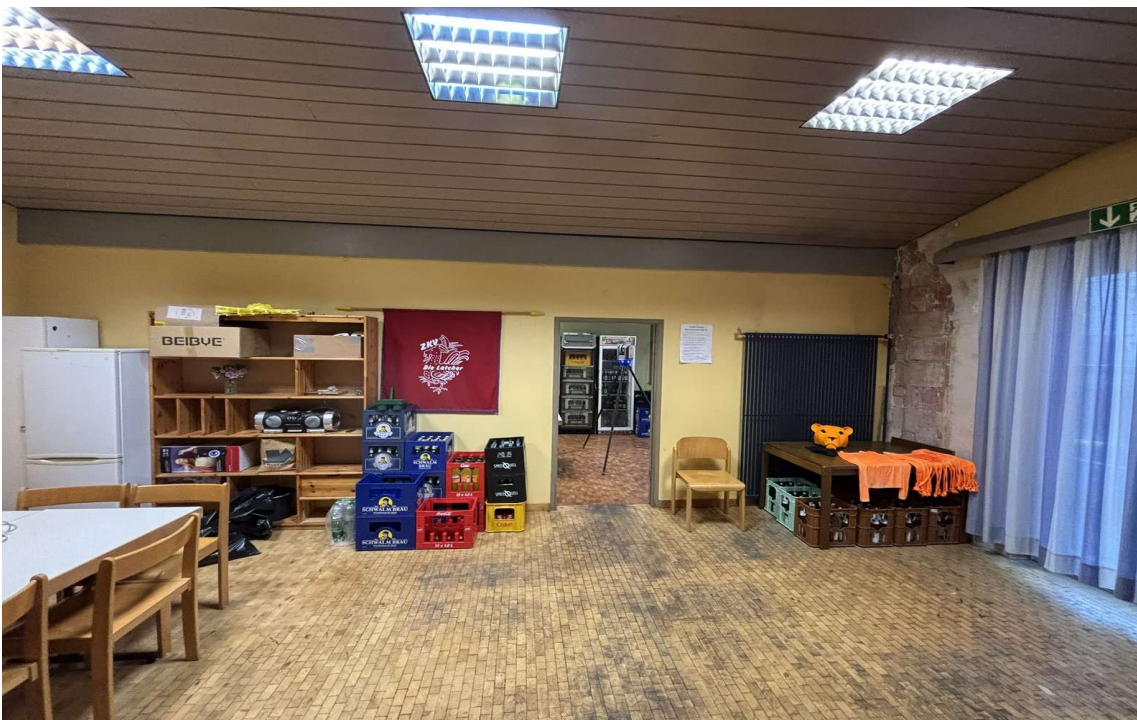
Gruppenraum mit Stirnholzpfaster, sichtbaren Mauerwerksschäden an der Außenwand.
