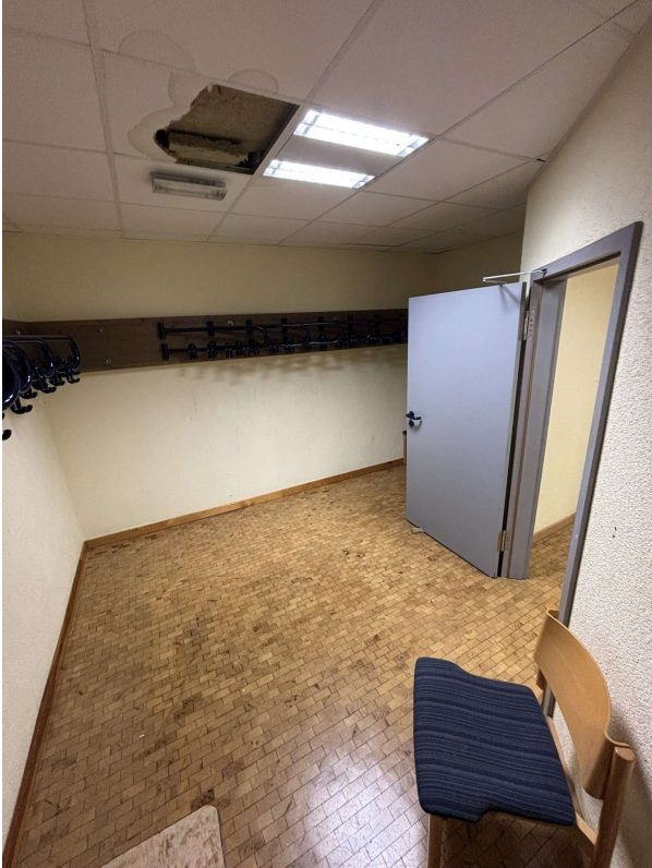
Garderobe mit Stirnholzplasterboden, Wandhaken und sichtbaren Feuchtigkeitsschäden an der Decke.
